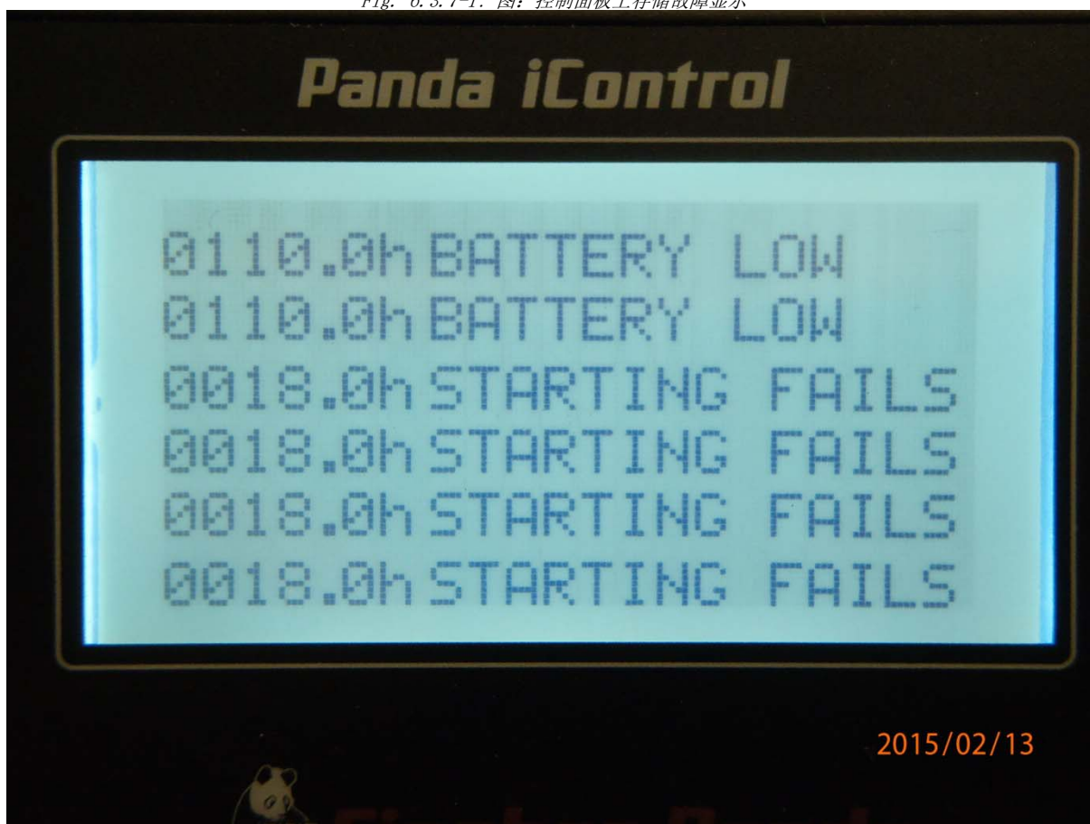
Fig. 6.3.7-1: 图：控制面板上存储故障显示
