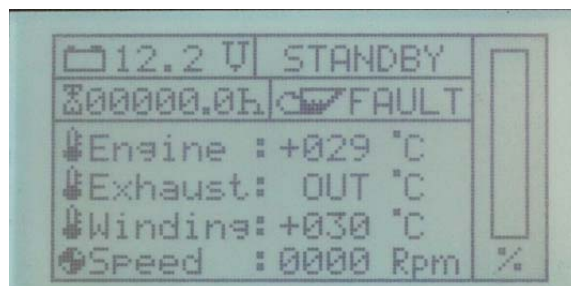
Fig. 6.2-1: 故障： „ 气缸盖温度超出范围 “
